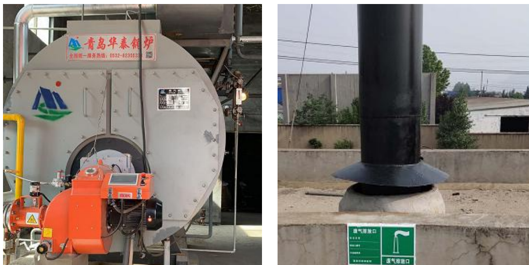
图 4-2 锅炉低氮燃烧和排气筒
