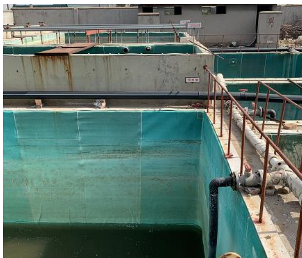
图 4-1 厂内污水处理站
